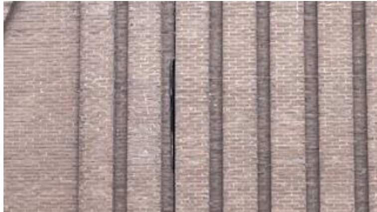
Foto 10: Dilatatie – gedeeltelijk beschadigd
